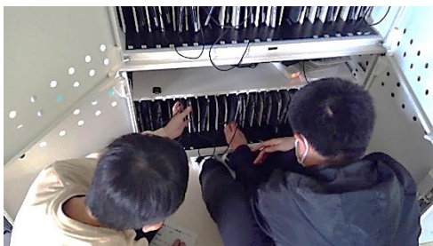
タブレット保管庫の点検 (ICT 委員会)
