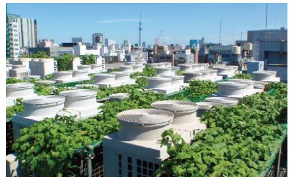
* 1 : 空調機上の芋緑化システム
